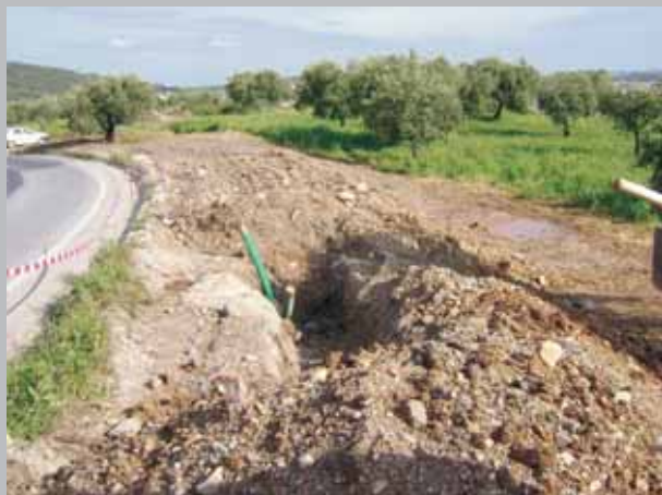
Condução de água Furo LS3 – Central dos Pragais
